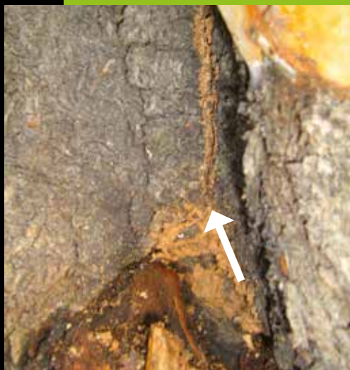
1 - Sillon provoqué par les cordonnets
